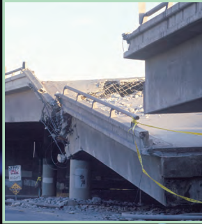
Derrumbes de puentes
