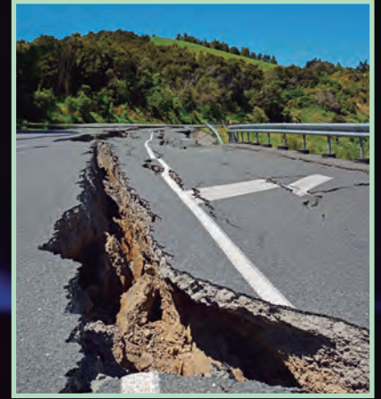
Daños en caminos y estructura vial
